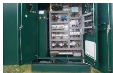
Poste de relèvement
