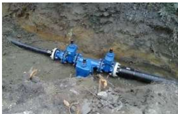
Réseau eau potable
